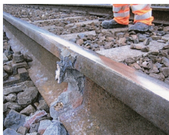
Entre Varzo et Preglia (km 11.6): une soudure mal exécutée. CFF
