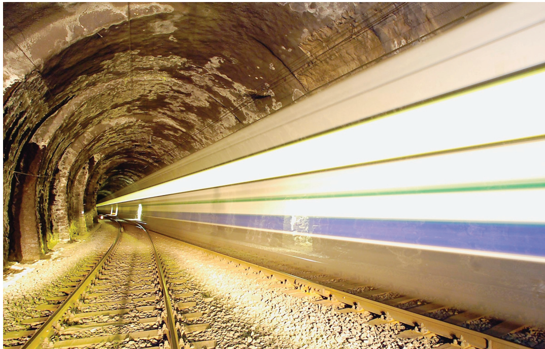
Le rapport interne des CFF relevait de nombreuses anomalies sur les voies italiennes. Y compris dans un tunnel. BITTEL/A
