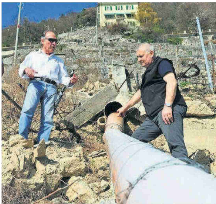
Bertrand Duboux et le vigneron Raymond Chappuis en Dézaley, au chevet d'une conduite d'écoulement endommagée. DI SANZIO
