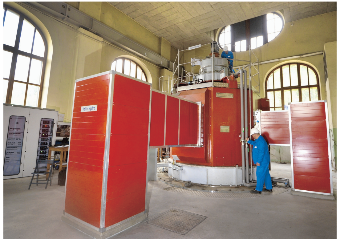
D'un poids de 60 tonnes, un nouveau groupe de production a été installé dans la centrale de la Vièze. Il remplacera les deux anciens groupes de 1959. SABINE PAPILLOU
